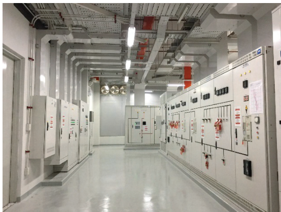
รูปที่ 8.3 ตัวอย่างห้องที่ติดตั้งแผงสวิตช์และพื้นที่ว่างเพื่อปฏิบัติงาน
